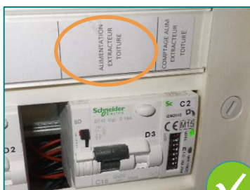
1 : Disjoncteur individuel et identifié pour la ventilation avec « Alimentation extraction toiture »
