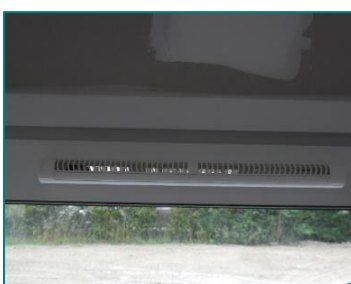
4 : Entrée d'air correctement mise en œuvre
