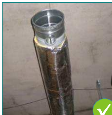
3 : Conduit rigide galva avec isolation rapportée en ventilation collective
