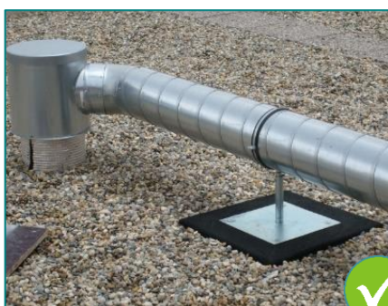
2 : Conduit rigide horizontal correctement supporté
