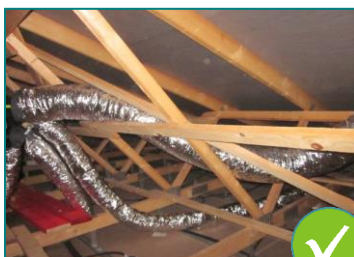
1 : Conduits souples correctement mis en œuvre (pas d'écrasement ni de coude supérieur à 90°)
