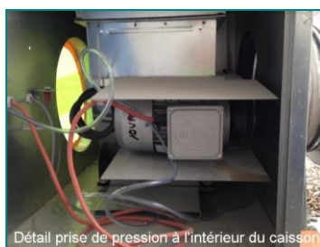
2 : Prise de pression depuis l'intérieur d'un caisson de ventilation
