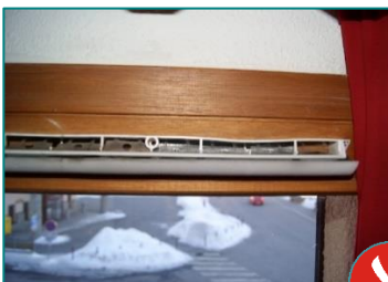
2 : Absence de mortaise derrière l'entrée d'air
