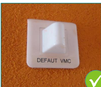
2 : Alarme correctement signalée
