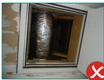
1 : Trappe mal positionnée par rapport aux conduits (accès bloqué par le conduit)
