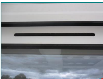
3 : Absence d'auvent extérieur
