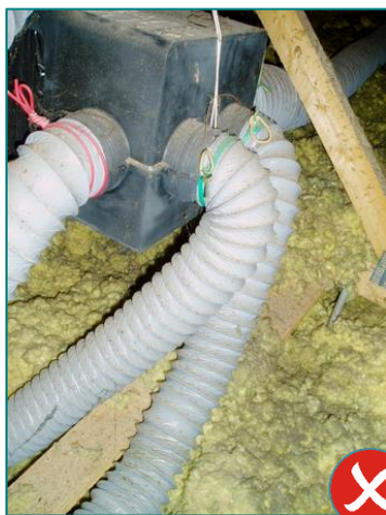
3 : Raccordements mal réalisés avec risque de débranchement
