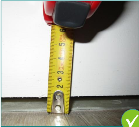
1 : Détalonnage suffisant d'une porte de chambre
