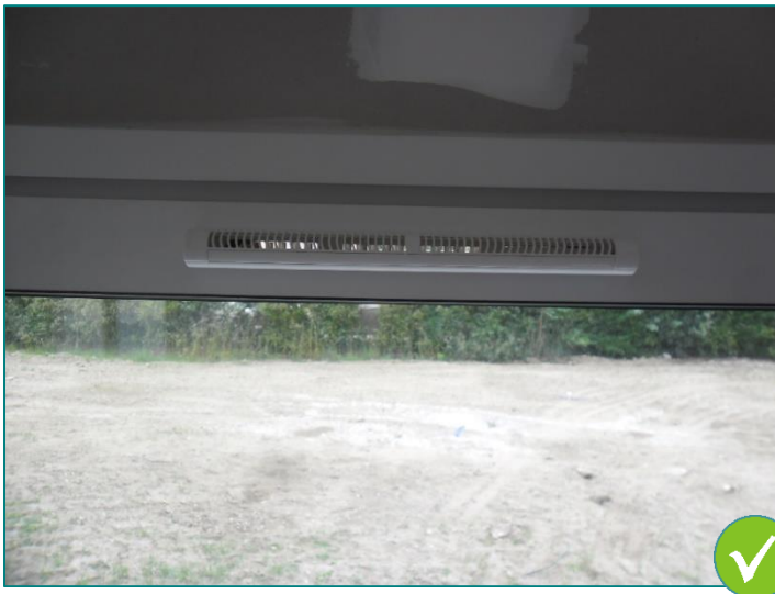
1 : Entrée d'air en bon état
