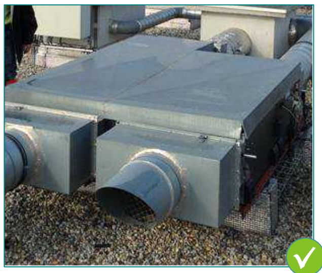
2 : Prise d'air neuf directement à l'extérieur en toiture terrasse
