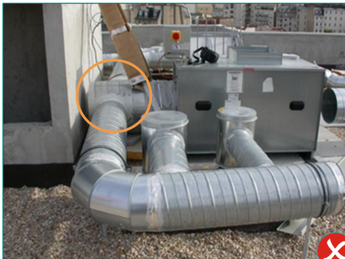
1 : Coude à 90° directement en sortie de caisson de ventilation
