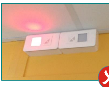
3 : Alarme non signalée
