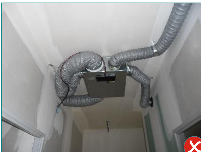
3 : Coudes importants directement au niveau des raccordements sur le caisson de ventilation en maison individuelle
