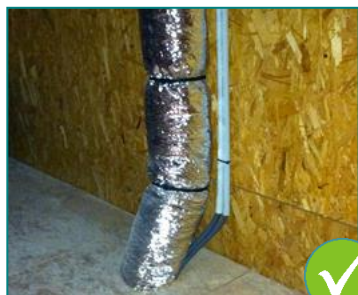
1 : Conduit souple isolé en maison individuelle
