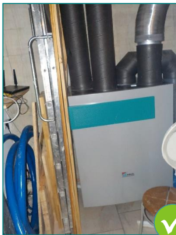
1 : Raccordements correctement réalisés sans défaut d'étanchéité visible
