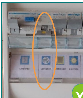
3 : Disjoncteur individuel et identifié pour la ventilation avec symbole + « ventilation »
