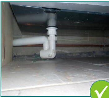
1 : Évacuation des condensats correctement réalisée
