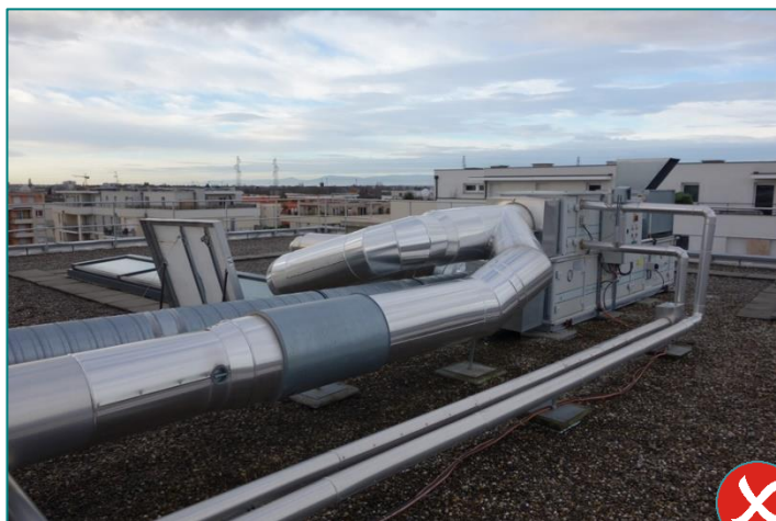
2 : Embranchement directement en sortie de caisson de ventilation
