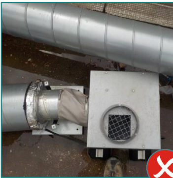
1 : Manchette pliée car mauvais alignement entre le caisson et le conduit
