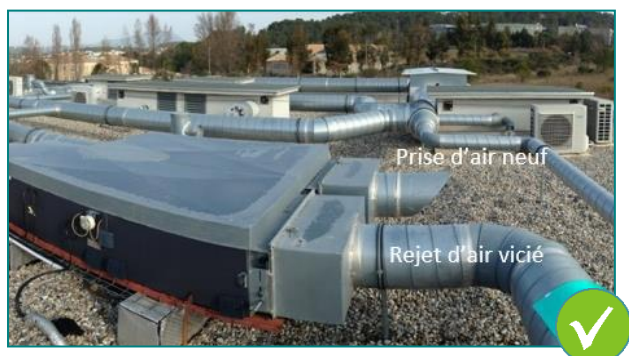
1 : Prise d'air neuf directement à l'extérieur en toiture terrasse
