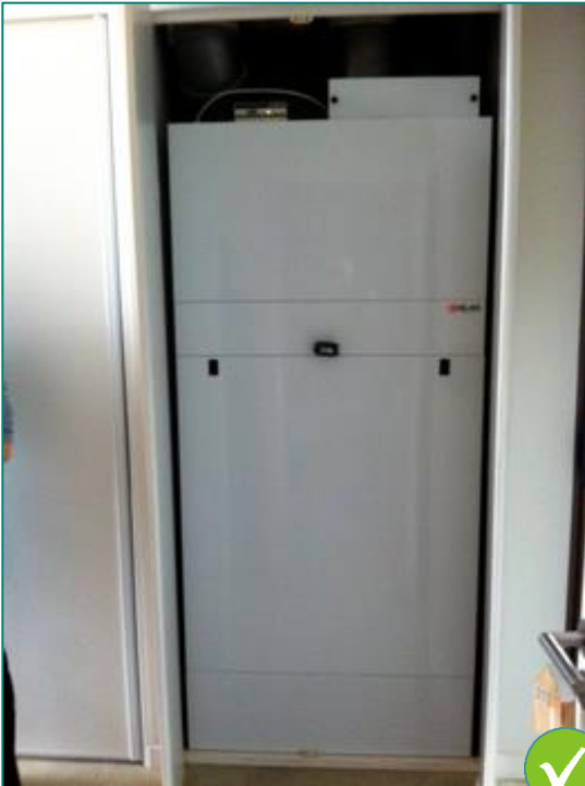
1 : Caisson de ventilation double flux installé dans le volume chauffé
