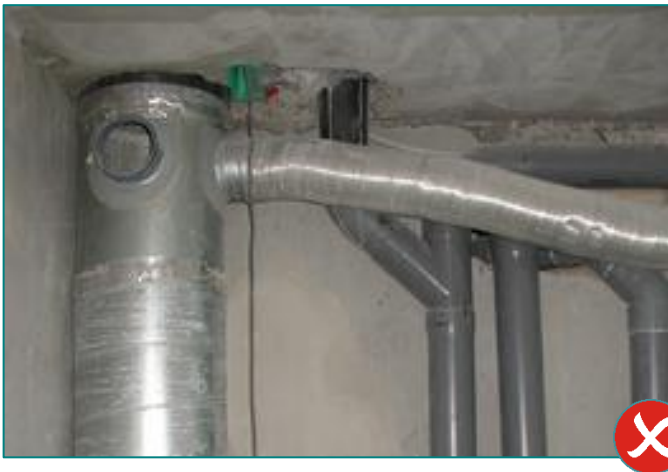
2 : Conduits souples en partie commune
