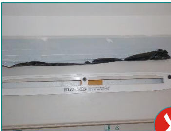
1 : Isolant obstruant complètement la mortaise
