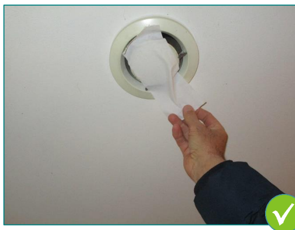
1 : « Test de la feuille de papier » positif pour une bouche d'extraction
