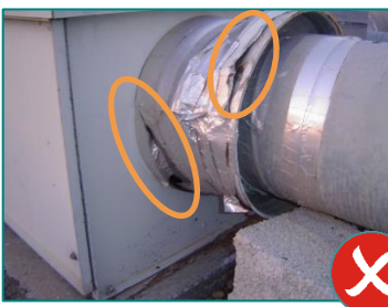
2 : Raccordements non étanches de la manchette
