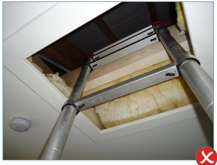
2 : Trappe d'accès encombrée et réduite
