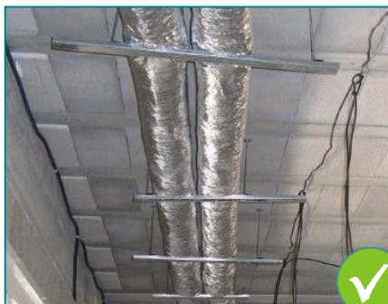
1 : Conduits souples correctement supportés
