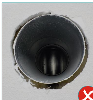
2 : Absence de dispositif de raccordement
