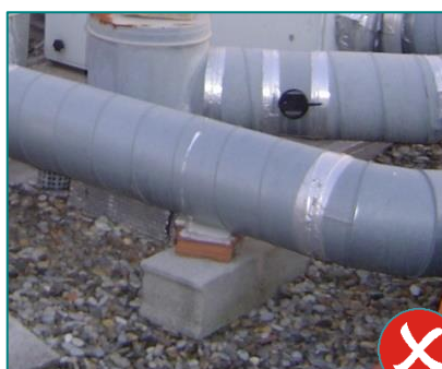
3 : Conduit rigide horizontal avec support NON adapté
