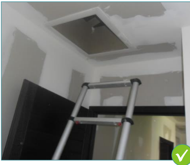
1 : Trappe d'accès correctement dimensionnée
