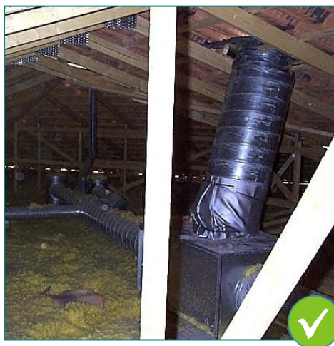
1 : Rejet correctement raccordé sur l'extérieur
