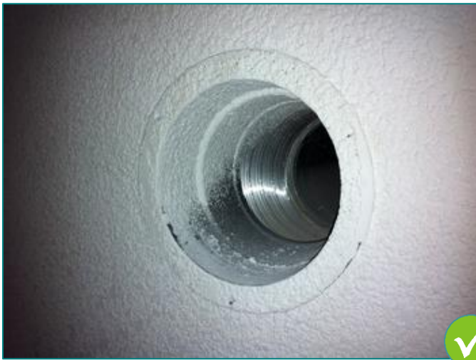
1 : Conduits souples en partie privative pour le raccord d'une bouche
