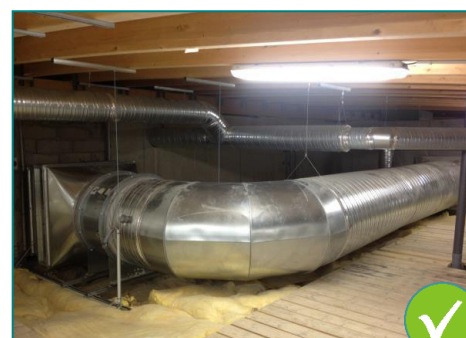
4 : Installation en conduits rigides correctement réalisée
