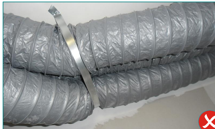
5 : Ecrasement des conduits souples par l'élément d'attache
